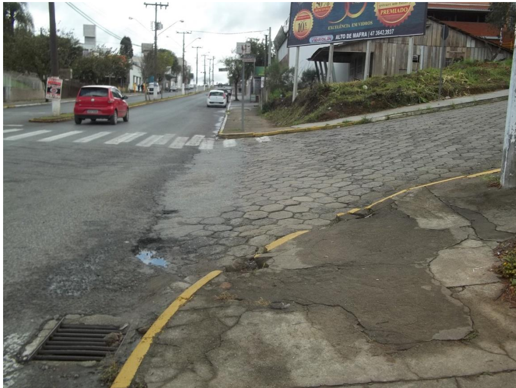
FOTO 36 CALÇADA COM PAVIMENTAÇÃO E GOLA DETERIORADAS – 16/07/2017
