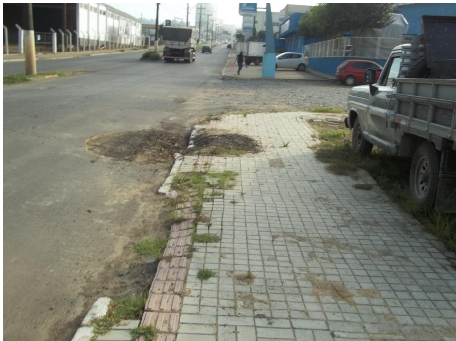
FOTO 12 AREA COM CALÇAMENTO, BOCA DE LOBO E MEIO FIO DETERIORADOS – 16/07/2017
