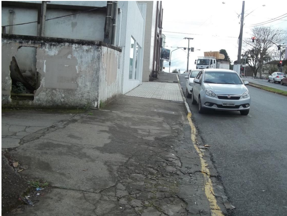
FOTO 39 CALÇADA COM PAVIMENTAÇÃO E REBAIXO DE MEIOS FIOS DETERIORADOS – 16/07/2017
