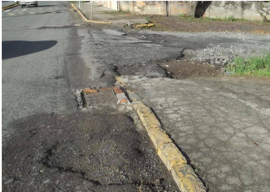
FOTO 21 ESQUINA COM PAVIMENTAÇÃO E BOCA DE LOBO DETERIORADOS– 16/07/2017
