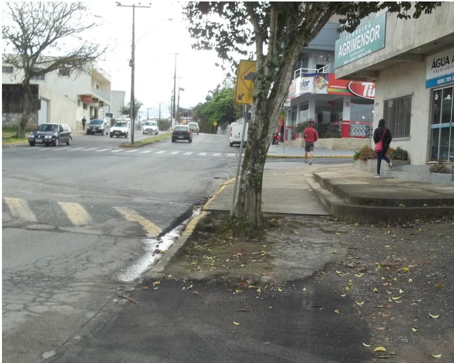
FOTO 33 CALÇADA COM PAVIMENTAÇÃO E REBAIXO DE MEIO FIO DETERIORADO E OBSTACULO (ÁRVORE ESP. INVASORA)– 16/07/2017
