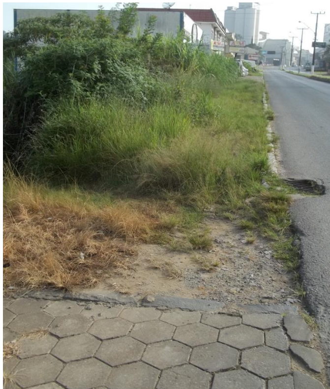
FOTO 18 AREA SEM CALÇAMENTO, BOCA DE LOBO E MEIO FIO DETERIORADOS – 16/07/2017
