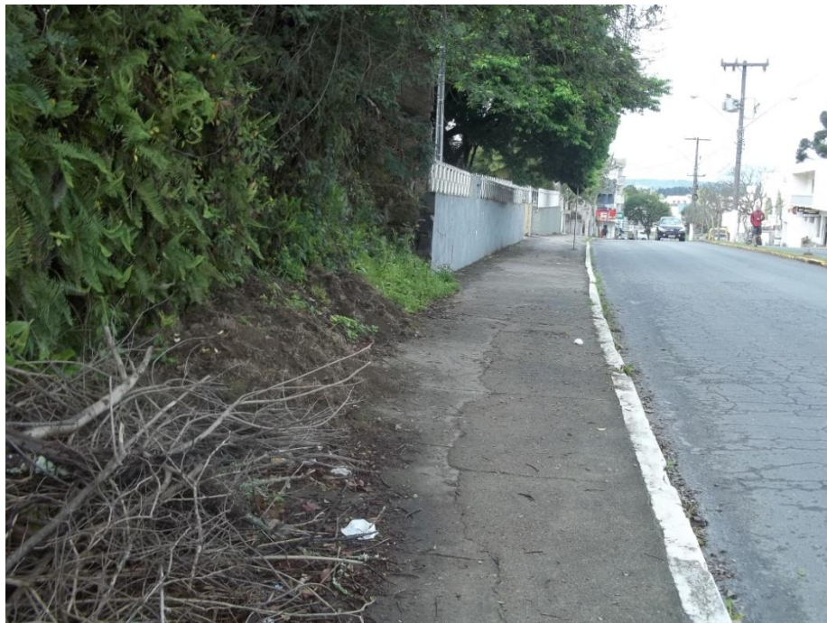
FOTO 34 CALÇADA COM PAVIMENTAÇÃO E MEIO FIO DETERIORADO SEM DEFINIÇÃO DE ALINHAMENTO PREDIAL– 16/07/2017
