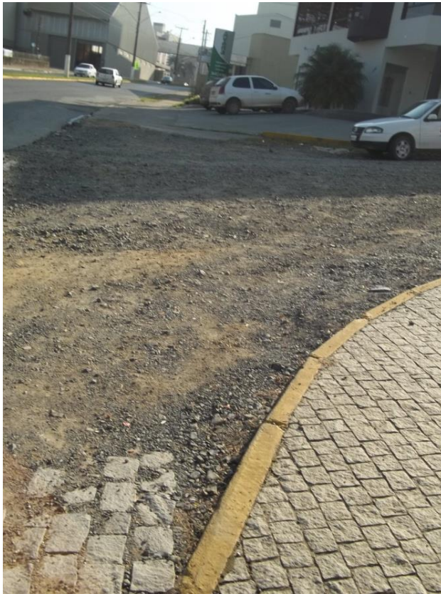
FOTO 19 AREA SEM PAVIMENTAÇÃO E BOCA DE LOBO – 16/07/2017
