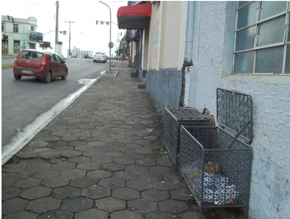
FOTO 37 CALÇADA COM PAVIMENTAÇÃO DETERIORADA E OBSTACULOS (LIXEIRAS E DEGRAUS)– 16/07/2017
