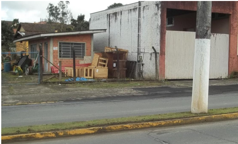
FOTO 32 CALÇADA COM PAVIMENTAÇÃO E REBAIXO DE MEIO FIO DETERIORADO– 16/07/2017
