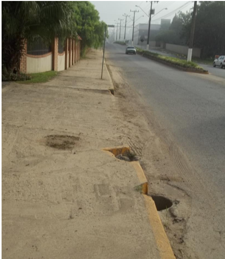
FOTO 05 DETERIORAÇÃO DO MEIO FIO E BOCA DE LOBO - 16/07/2017
