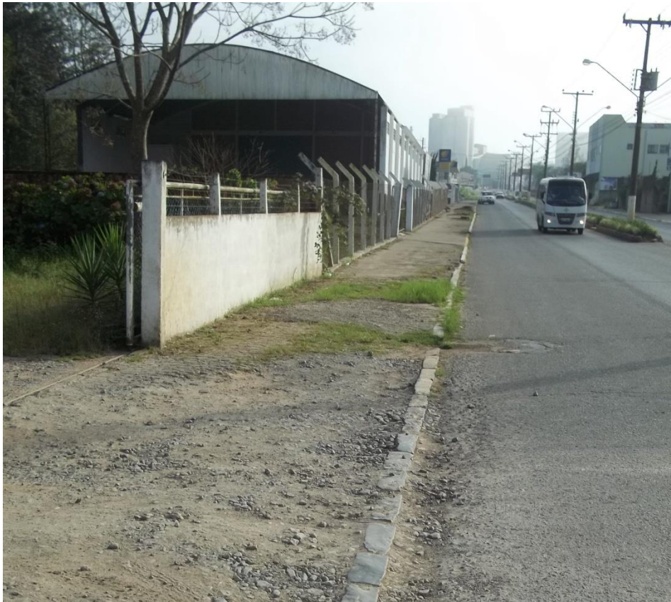
FOTO 13 AREA SEM CALÇAMENTO E MEIO FIO DETERIORADO- 16/07/2017
