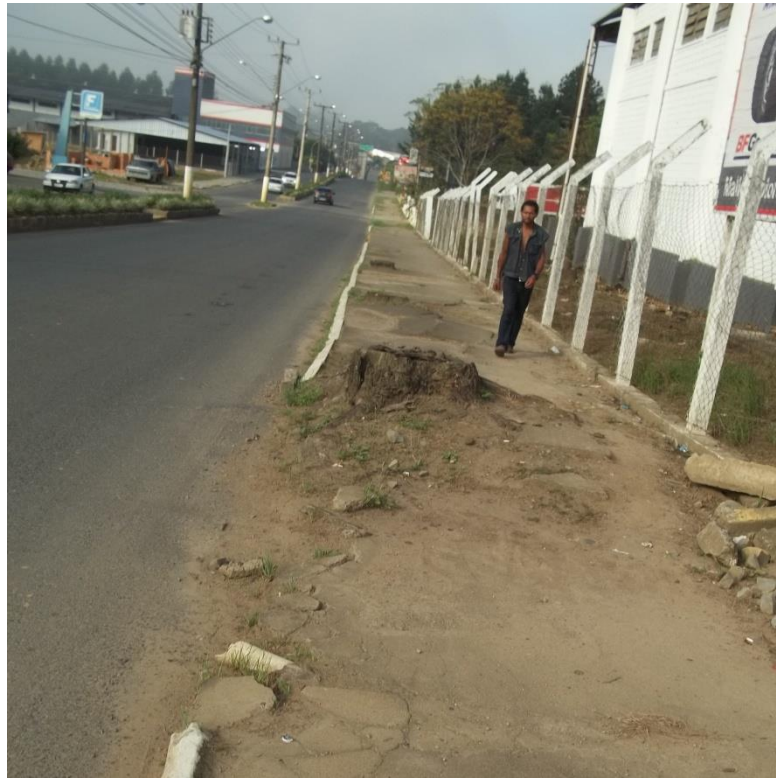
FOTO 15 AREA COM CALÇAMENTO E MEIO FIO DETERIORADO E RAIZ DE ÁRVORE EM MEIO A CALÇADA – 16/07/2017.
