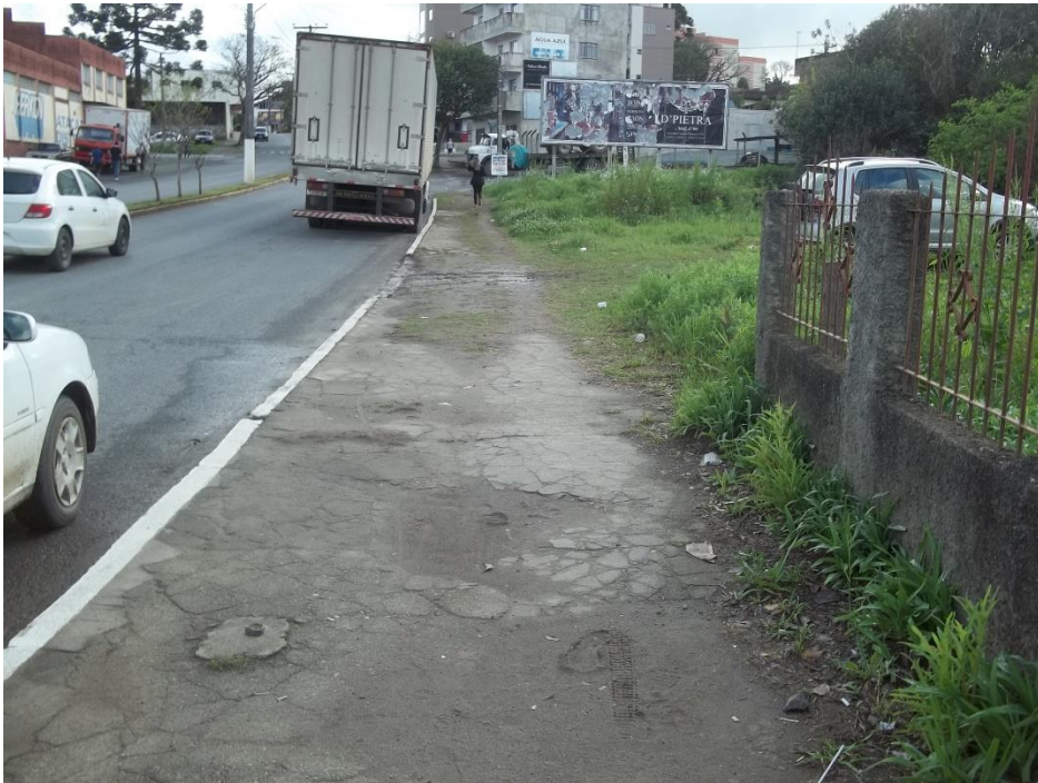
FOTO 29 CALÇADA COM PAVIMENTAÇÃO DETERIORADA– 16/07/2017
