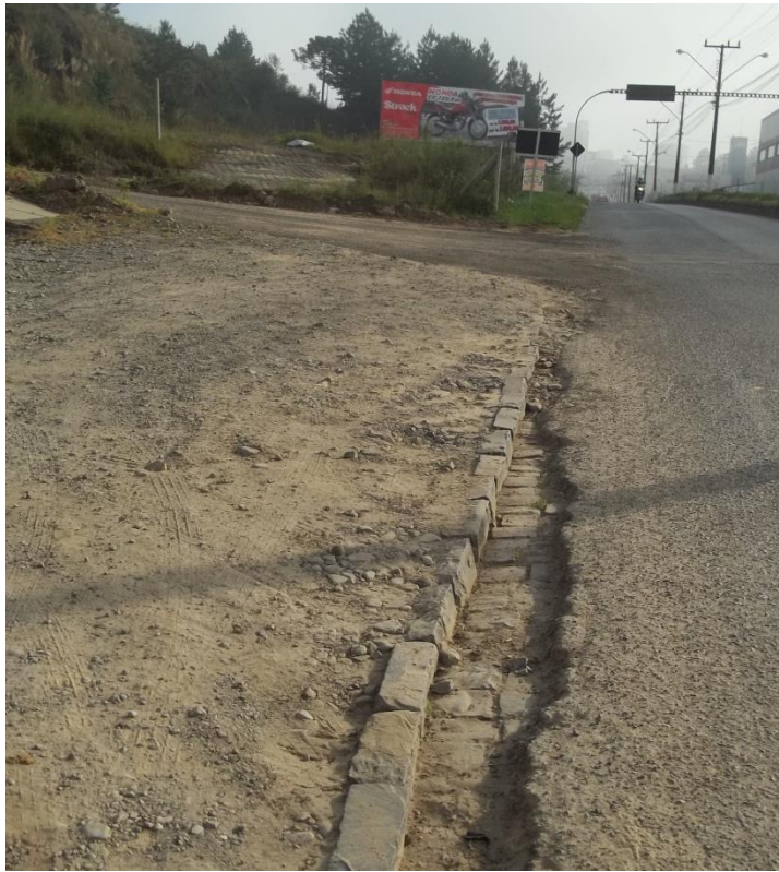
FOTO 07 AREA SEM CALÇAMENTO E MEIO FIO DETERIORADO ESQUINA COM RUA INDUSTRIAL JOSÉ ERNESTINO CASSIAS PEREIRA - 16/07/2017
