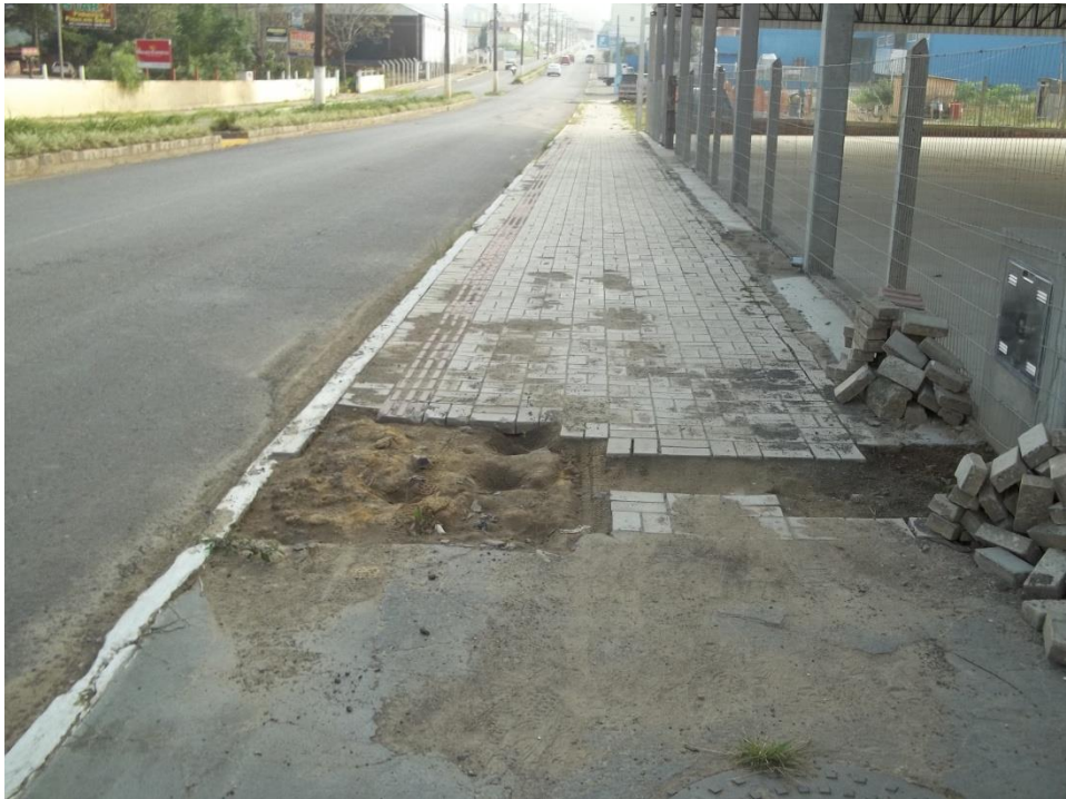
FOTO 11 AREA COM CALÇAMENTO DETERIORADO – 16/07/2017
