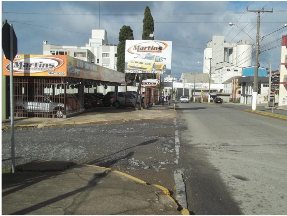
FOTO 25 ESQUINA SEM GOLA, PAVIMENTAÇÃO E MEIO FIO DETERIORADOS– 16/07/2017
