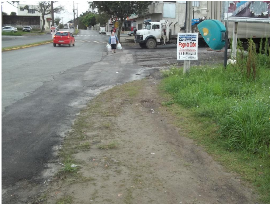
FOTO 31 CALÇADA SEM PAVIMENTAÇÃO E SEM MEIO FIO– 16/07/2017
