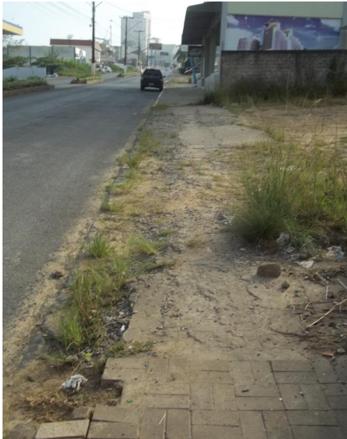
FOTO 17 AREA SEM CALÇAMENTO E MEIO FIO DETERIORADO 16/07/2017
