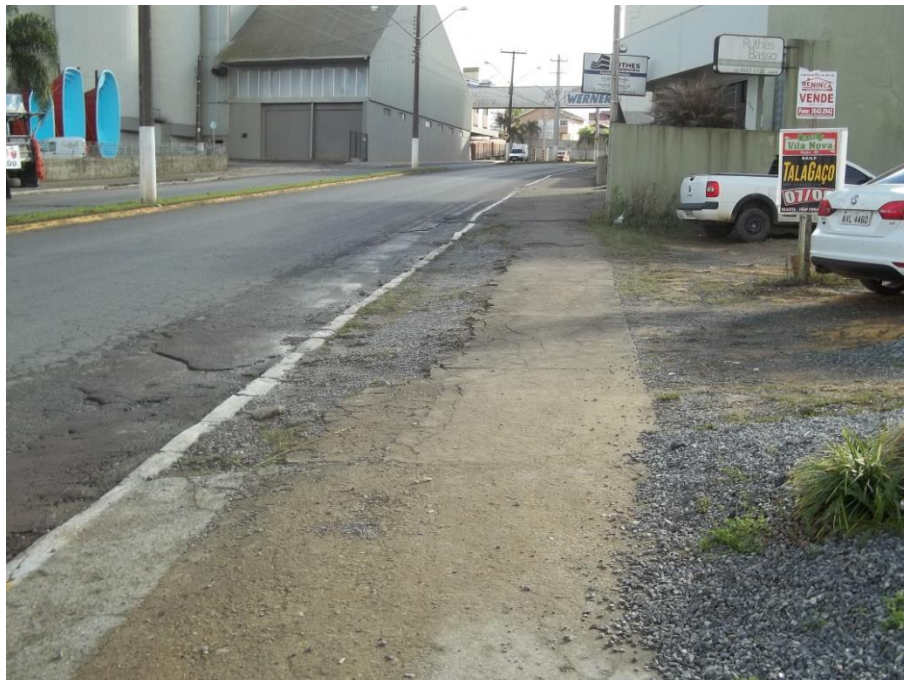
FOTO 22 AREA COM CALÇADA DETERIORADA– 16/07/2017
