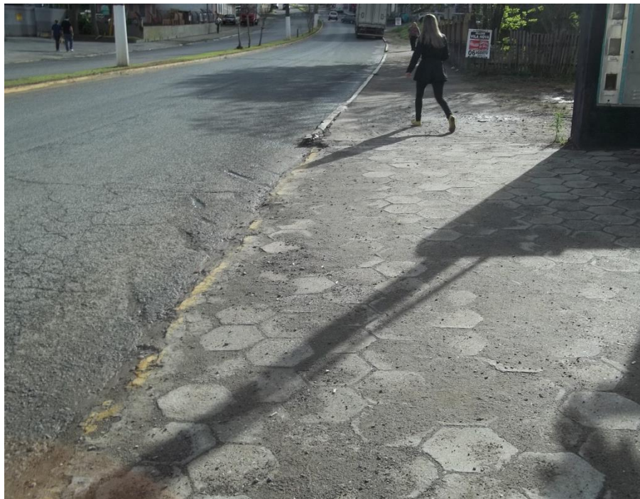
FOTO 28 CALÇADA COM PAVIMENTAÇÃO E REBAIXO DE MEIO FIO DETERIORADO– 16/07/2017
