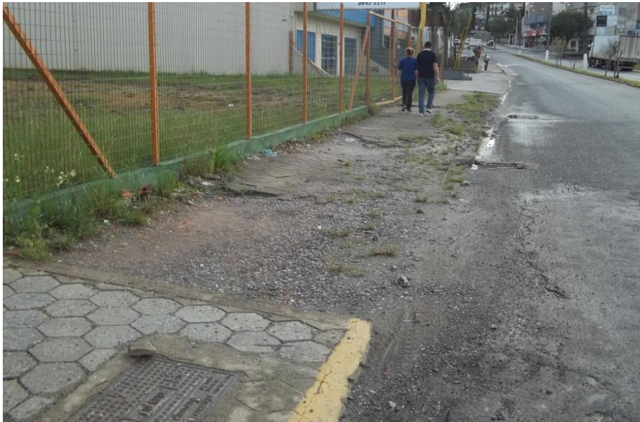
FOTO 27 CALÇADA SEM PAVIMENTAÇÃO E MEIO FIO DETERIORADO– 16/07/2017
