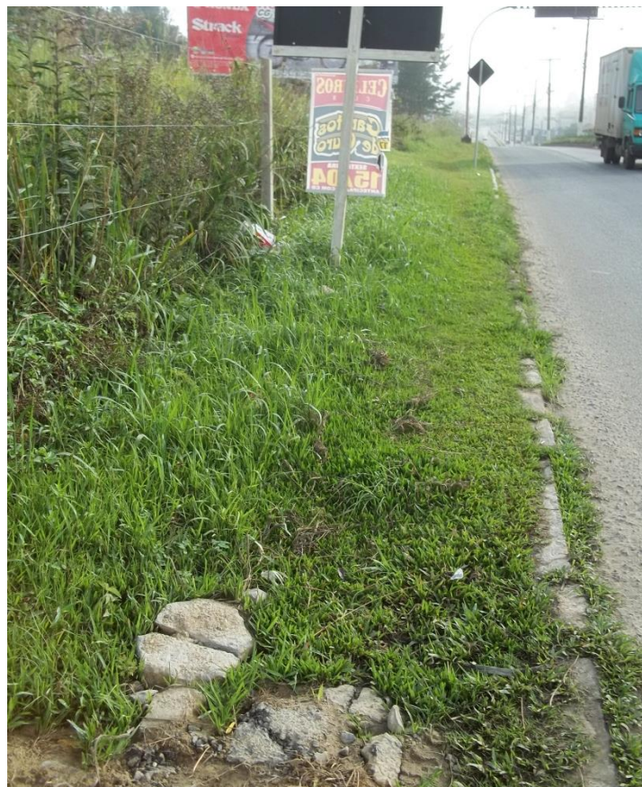
FOTO 08 AREA SEM CALÇAMENTO E MEIO FIO DETERIORADO – 16/07/2017
