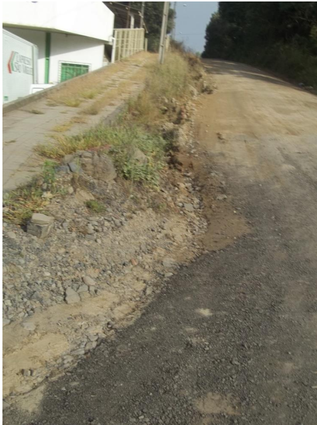
FOTO 09 ÁREA DETERIORADA ESQUINA RUA JOSÉ ERNESTINO CASSIAS PEREIRA – 16/07/2017
