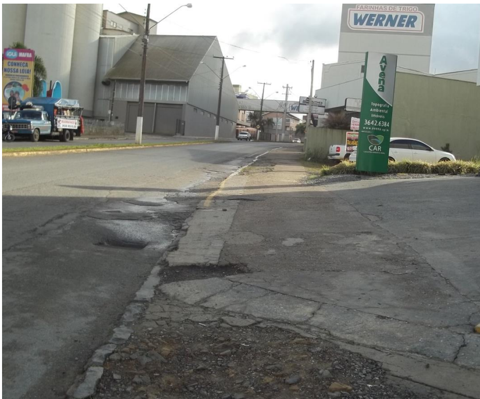
FOTO 20 AREA COM PAVIMENTAÇÃO E BOCA DE LOBO DETERIORADOS – 16/07/2017
