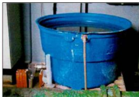
Figura 26 – Tanque de Dosagem da Barrilha. Fonte: PMSB (2010).
