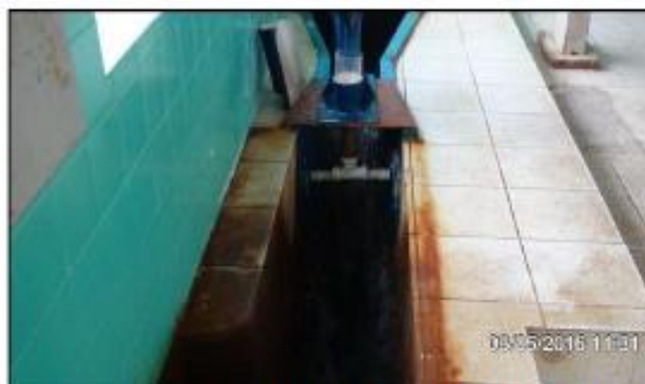
Figura 14 – Calha Parshall para promoção de mistura rápida.
