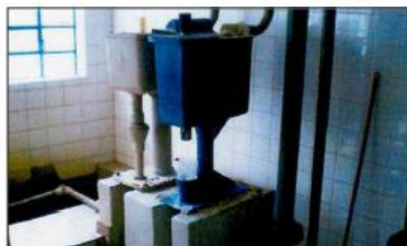
Figura 24 – Dosadores de Sulfato de Alumínio. Fonte: PMSB (2010).
