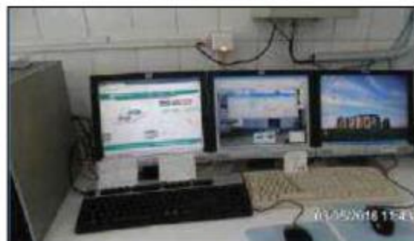
Figura 28 – Sistema Supervisório da ETA. Fonte: RF-SAA-Mafra-002 (ARIS, 2016).
