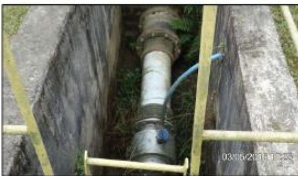
Figura 13 – Adutora de chegada de água bruta dotada de macromedidor eletromagnético.
