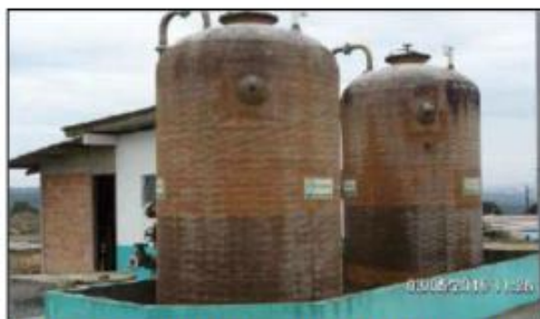
Figura 18 – Reservatório de armazenamento do PAC.
