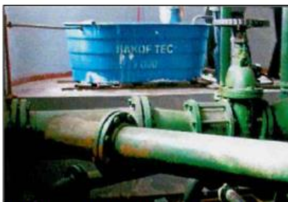
Figura 25 – Tanque de preparo da Barrilha. Fonte: PMSB (2010).
