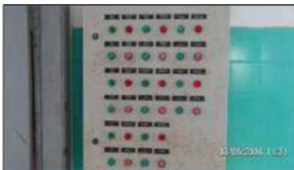
Figura 21 – Quadro de Comando das Unidades Mecânicas da ETA. Fonte: RF-SAA-Mafra-002 (ARIS, 2016).
