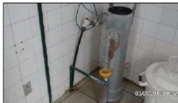
Figura 22 – Dosagem de Flúor (Fluorsilicato de Sódio) por Saturação. Fonte: RF-SAA-Mafra-002 (ARIS, 2016).
