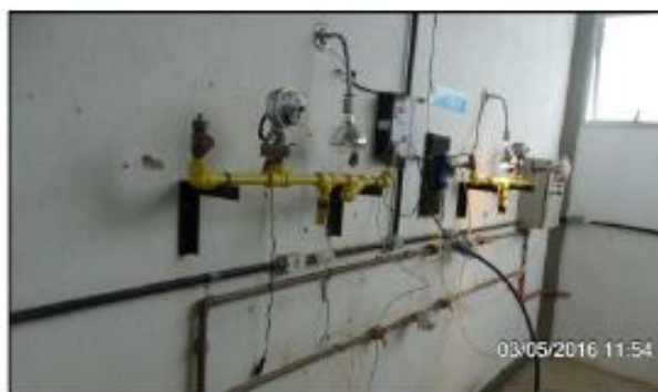
Figura 20 – Dosagem do cloro gasoso.
